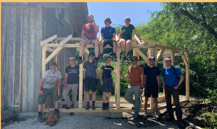
Ehemalige Volontäre des ZUK sind zufrieden mit dem Gerüst des Anbaus an der Vogelstation Moosmühle.
